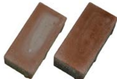
Povrch dlažby s vápenným výkvetom pred čistením a po vyčistení Rebanitom S
